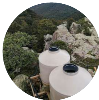
Foto: Los 2 tinacos instalados en una zona con mayor altitud permiten un abastecimiento de agua al vivero usando gravedad, reduciendo considerablemente el uso de electricidad. Para tratar el agua residual del baño, un biodigestor fue instalado para evitar la contaminación del humedal adyacente.
